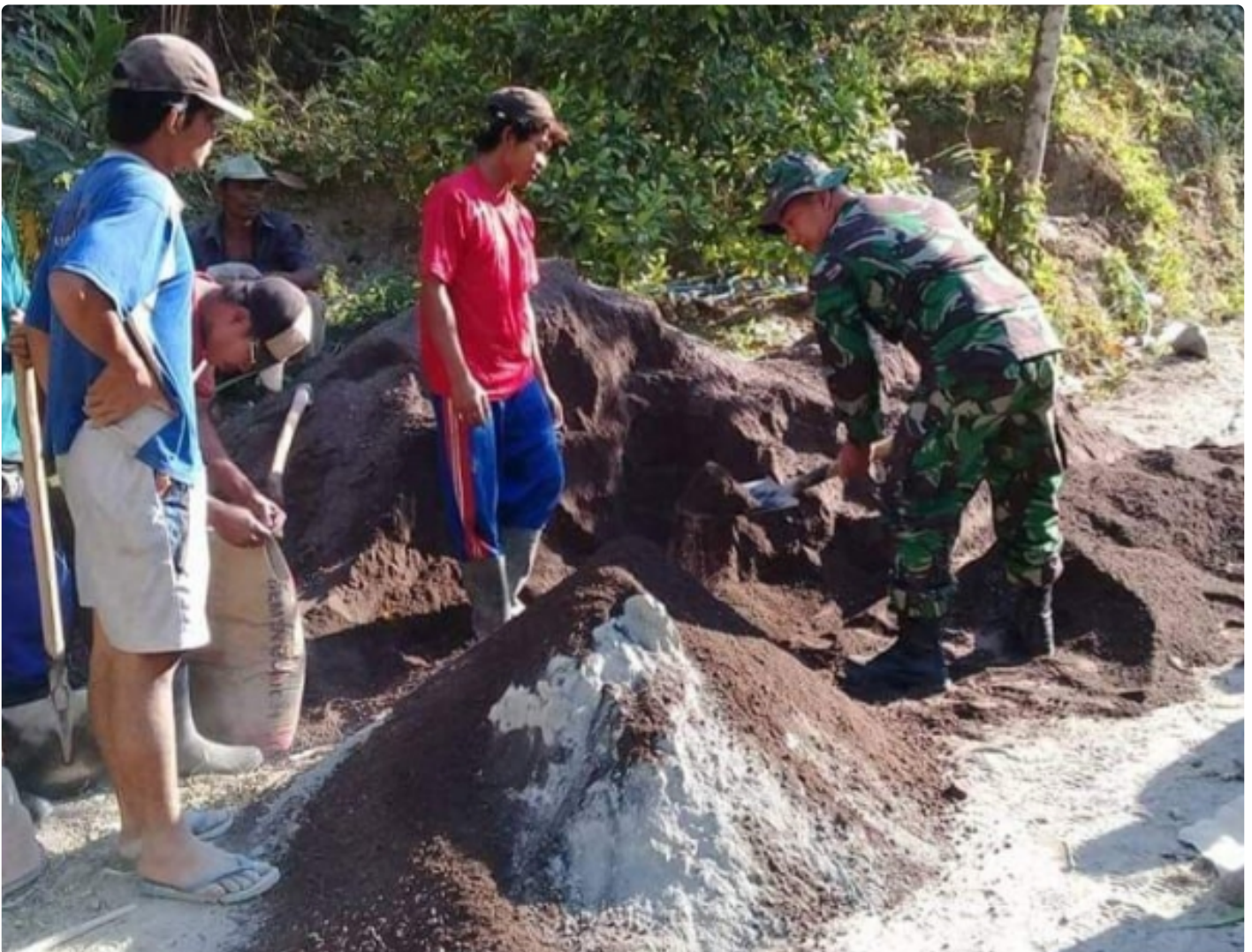
Babinsa Koramil Banjar melaksanakan rabat beton, merupakan pelaksanaan tugas pembinaan wilayah binaannya
